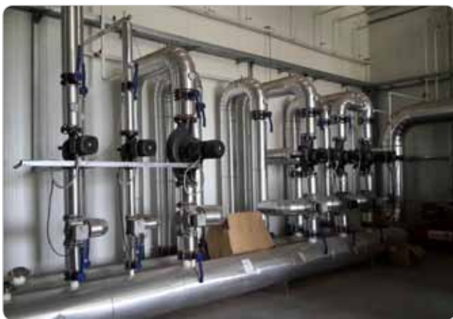
Obr. 5 Pohľad na rozdeľovač a zberač vykurovania
